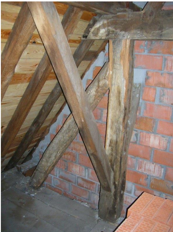
Afbeelding 18: bovenste spantdeel op zolder restant is van een vakwerkstructuur
