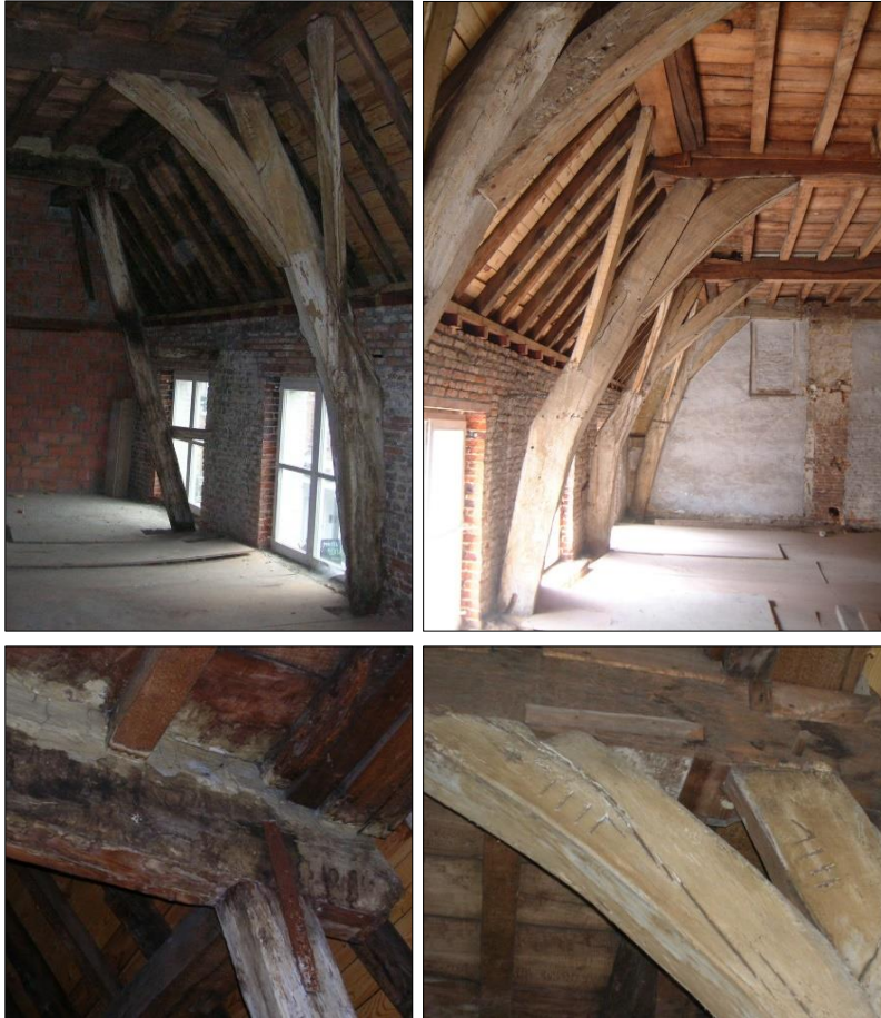
Afbeelding 20: (linksboven) spant 7 en 8 Afbeelding 21: (rechtsboven) spanten 8-11 Afbeelding 22: knoop spant 7 Afbeelding 23: knoop spant 8
