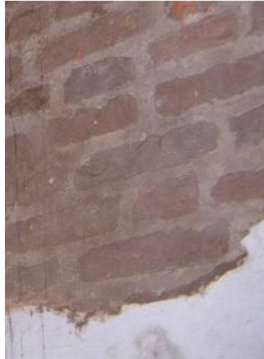
Afbeelding 2: dicht gemetst raam kapel in de kopse gevel
