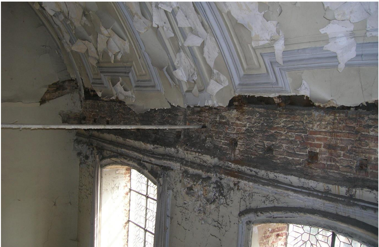
Afbeelding 11-12: zichten op het tongewelf en sterk beschadigde stucwerk, sporen van huiszwam
